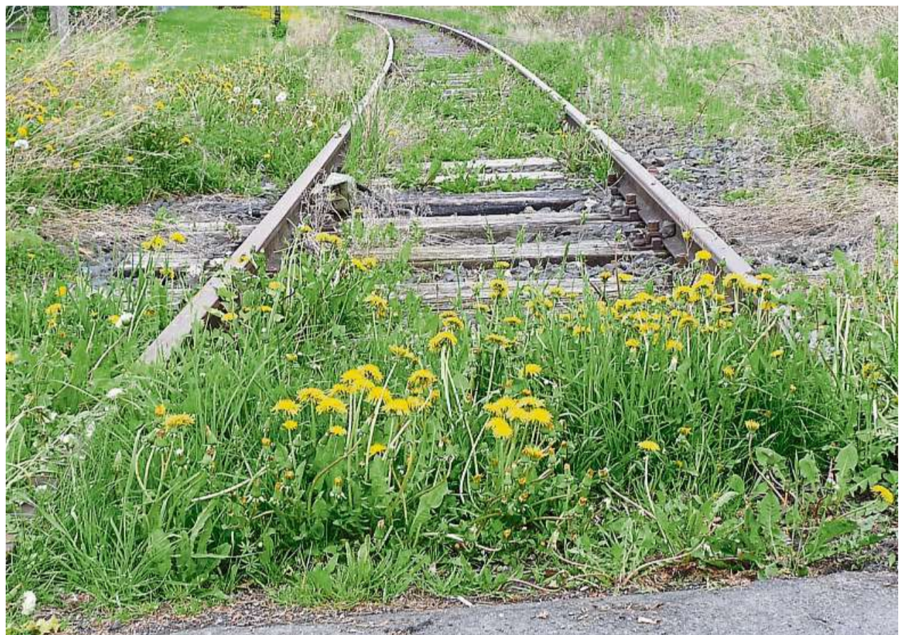
In der neuen Kostenberechnung für die Reaktivierung ist auch die Erneuerung der Gleisanlage enthalten.
